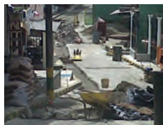
Obras de renovación conducción al Tanque de la Independencia, falta adecuación y repavimentación en vías.
