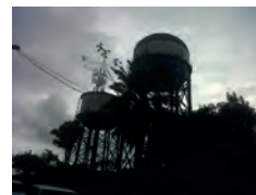
Tanque elevado de almacenamiento
