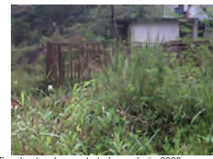
Planta de Escalarete, obra contratada en el año 2008 con recursos del FNR, obras inconclusas y sin funcionar.
