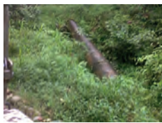
Estado de la tubería de aducción, presenta fugas en varios tramos
