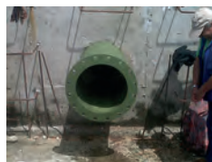
Tubería Tanque de la Independencia
