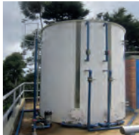
Planta y dosificador de cloro
