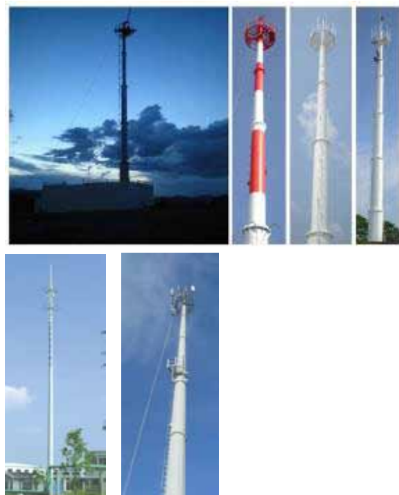
FIGURA 6-3. Estructuras de soporte tipo monopolo
