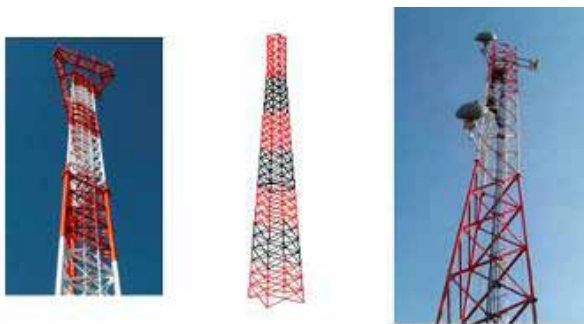
FIGURA 6-2. Estructuras de soporte tipo torres
