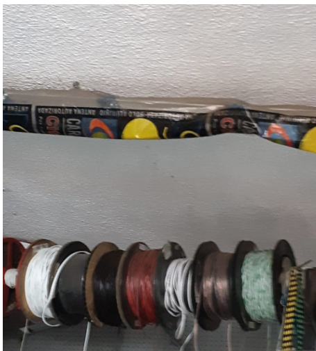
Fotografía 5. Fisura en la placa de contrapiso al interior del predio de la Av. Carrera 70 No 70 -36, en el Sector Catastral de la Estrada.
