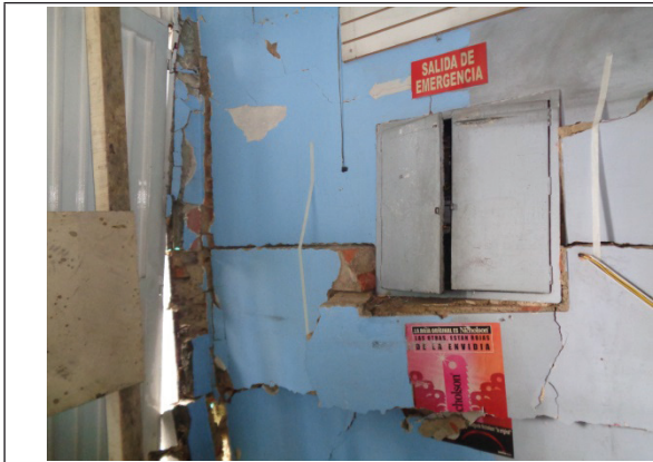
Fotografía 2. Fracturas de tendencia horizontal del predio de la Av. Carrera 70 No 70 -36, en el Sector Catastral de la Estrada de la Localidad de Engativá.
