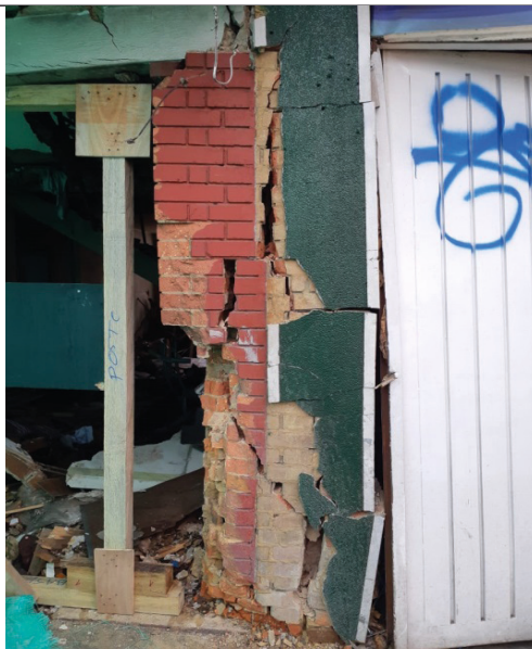
Fotografía 7. Fracturas en las mochetas, localizadas en la entrada de los predios de la Av. Carrera 70 No 70 -40 y Av. Carrera 70 No 70 -36.
