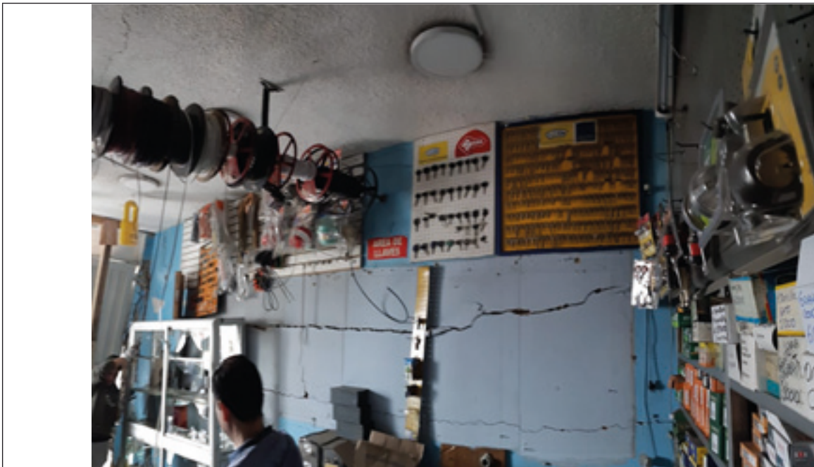
Fotografía 4. Grietas de tendencia horizontal en la parte posterior del muro del costado norte del predio de la Av. Carrera 70 No 70 -36, en el Sector Catastral de la Estrada de la Localidad de Engativá.
