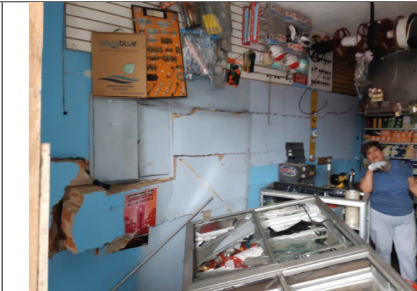
Fotografía 3. Fracturas de tendencia horizontal del predio de la Av. Carrera 70 No 70 -36, en el Sector Catastral de la Estrada de la Localidad de Engativá.
