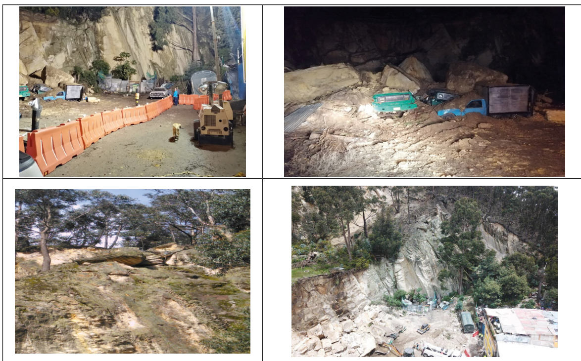
Fotografía 4: Sector Afectado. Fuente COP 1 Y COP 3
