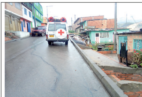
Fotografía 13. Grieta sobre la vía de la Carrera 16, al frente de las Manzanas H y G del CT-4469 en el Barrio Divino Niño de la Localidad de Ciudad Bolívar.
