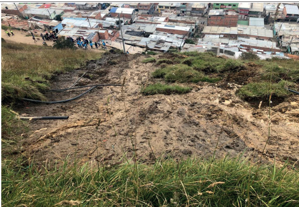
Fotografía 3. Viviendas localizadas en la parte baja de la ladera en el Sector de la Calle 76 Bis Sur entre Carreras 73B y 73C, en el Barrio Caracolí en la Localidad de Ciudad Bolívar.
