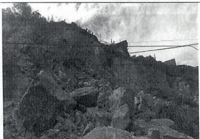
Fotografía 7. Desprendimiento de rocas en noviembre del 2017.
