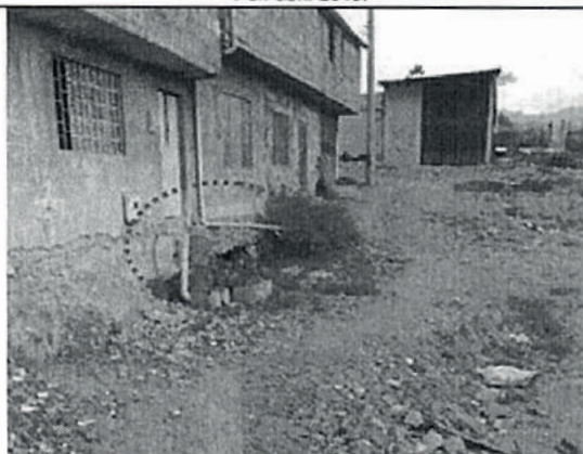
Fotografía 11. Avance en la pérdida de cimentación del predio 3 Mayo 2019.
