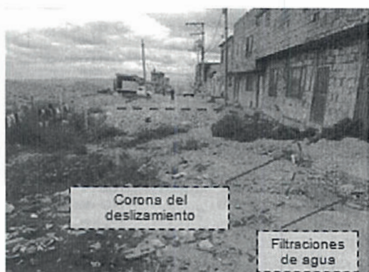
Fotografía 3. Grieta de tracción que alcanza la cimentación de las viviendas. Octubre 2019
