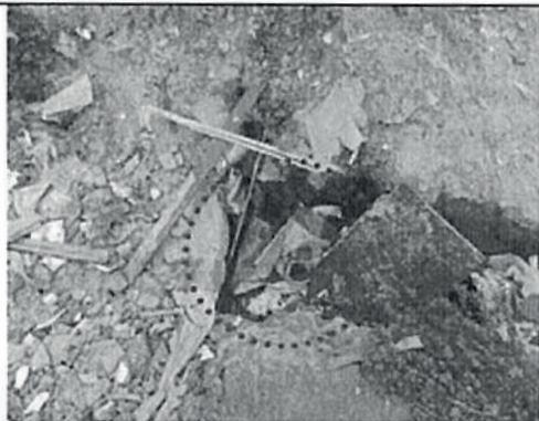
Fotografía 16. Vista de las conexiones erradas en la parte superior del deslizamiento.
