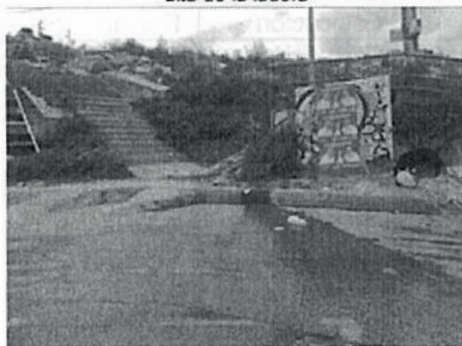
Fotografía 18. Filtraciones de agua en la parte baja de la ladera
