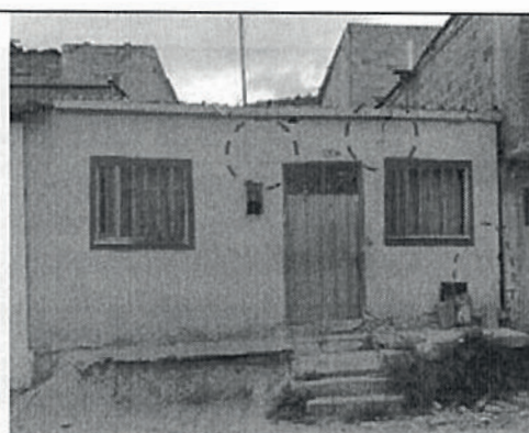
Fotografía 10. Presencia de daños desde el exterior del Predio 1 en octubre 2019
