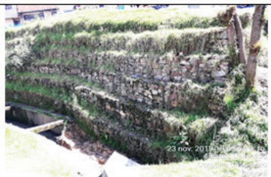
Fotografía 12. Vista general del costado sur del muro de gaviones, identificando leve deformación del mismo – 23/11/2019
