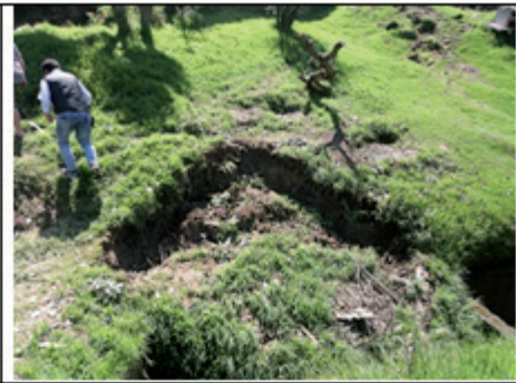
Fotografía 14. Material desprendido en la base del talud cerca del Canal Cataluña – 23/11/2019
