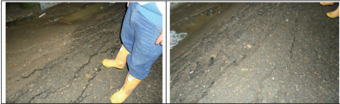
Fotografías 1 y 2. Grietas de tracción identificadas en el pavimento asfáltico de la Carrera 4 Este – 20/11/2019
