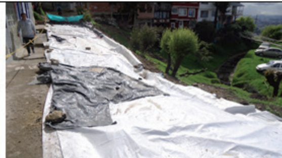
Fotografía 16. Vista de la Carrera 4 Este en el tramo afectado – 26/11/2019.
