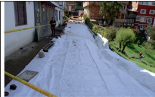
Fotografía 5. Fractura identificada en el sardinel de confinamiento en concreto – 20/11/2019
