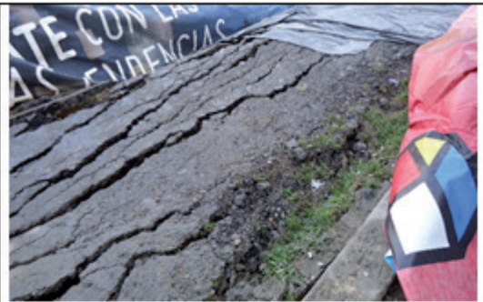
Fotografía 6. Desprendimiento de las losas de concreto y de suelo en la margen izquierda del Canal Cataluña – 20/11/2019
