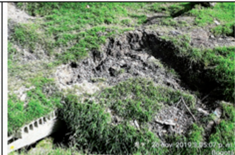
Fotografía 17. Desprendimiento de material en la base del talud – 26/11/2019
