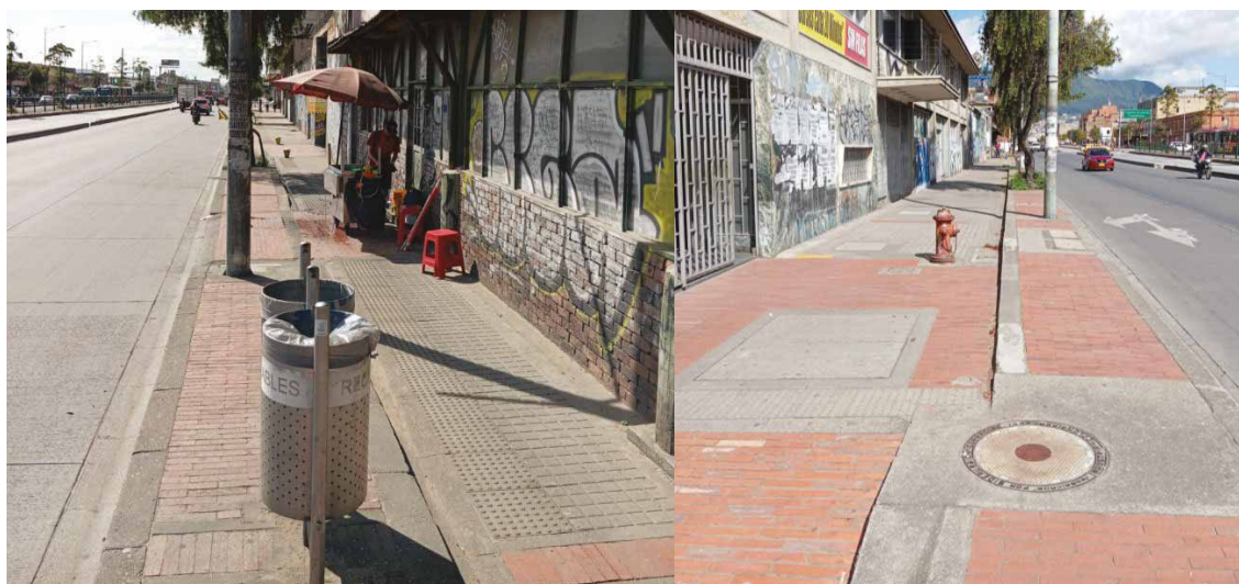
Ilustración 41 Estado andén de la calle 13 Fuente: Archivo Polaris Constructora
