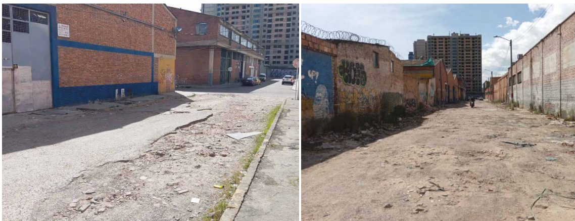
Ilustración 40 Estado del andén de la calle 14 Fuente: Archivo Polaris Constructora
