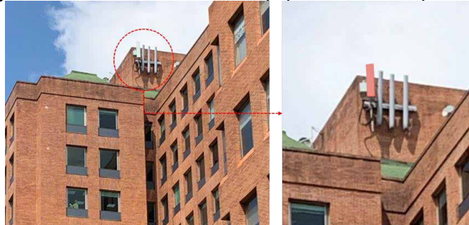
Figura 1.12 - Estaciones radioeléctricas de pequeño formato sobre puntos fijos
