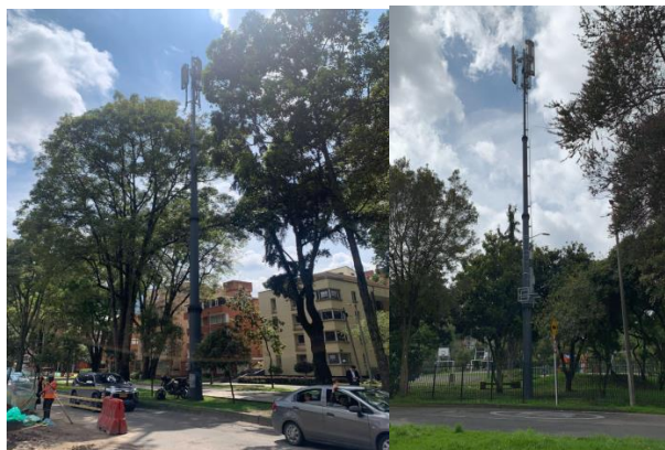
Figura 1.16 Estaciones radioeléctricas tipo monopolo, instaladas en el espacio público.
